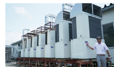
熱心な営業活動の甲斐あって、現在もリプレースを繰り返して稼働を続ける電子機器・部品メーカーの GHP
